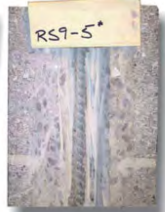
Vista en corte de un relleno de bloques utilizando el Rebar Shaker® de Oztec.
